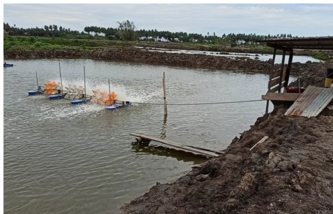
Gambar 3. Kincir Air Dengan Penggerak Mesin Diesel 8PK.
