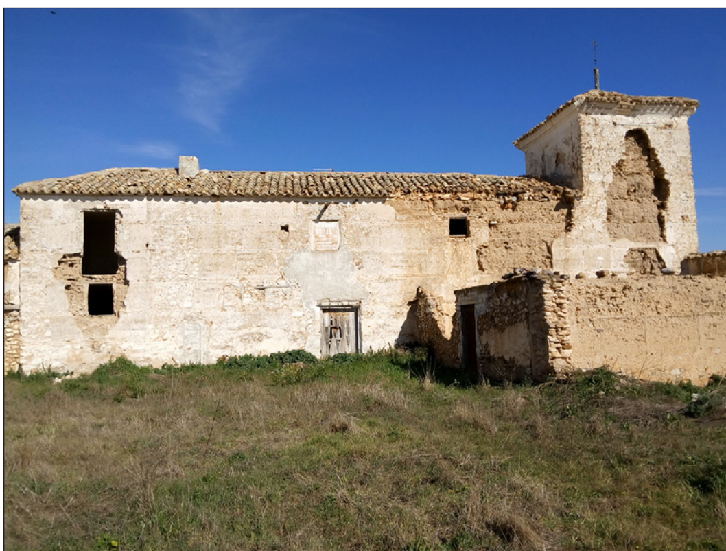
Figura 10. Venta de Borondo. Labores de enladrado, 2017. Fotografía digital: Asociación Cultural Venta de Borondo y Patrimonio Manchego
