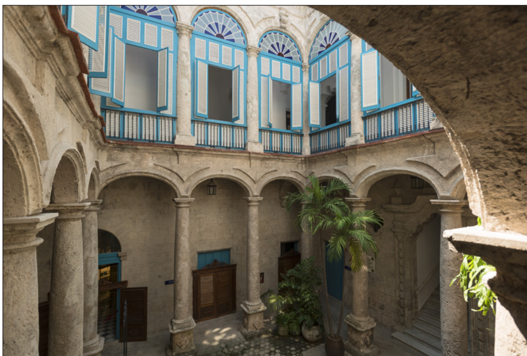
Figura 3. Vista interior del Palacio del Segundo Cabo. En la figura se aprecia el patio central de reducidas dimensiones y marcada verticalidad. El acceso a este es a través de una armoniosa sucesión de arcos de diferentes estilos. En el piso de la planta alta la galería se encuentra cerrada por persianería francesa con lucetas de colores, donde se agrupan tres ventanas centrales y las dos de cada lado por medio de cuatro pilastras de perfecta armonía. Foto: Néstor Martí.
