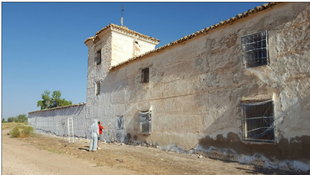
Figura 9. Venta de Borondo. Patologías en Alzado Oeste, 2016. Fotografía digital: David Cejudo
