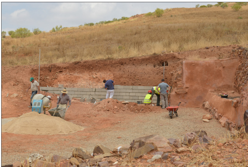
Fig. 2. Proceso de tapiado del perfil, durante la campaña de 2015. Fotografía: J. Blázquez (2015)
