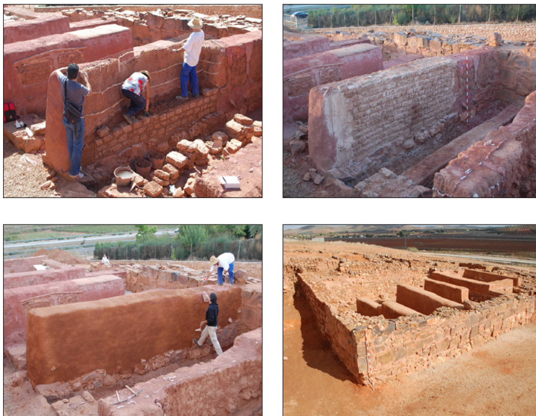
Figuras 8-II. Proceso de restauración de una estructura dañada parcialmente por la lluvia.
