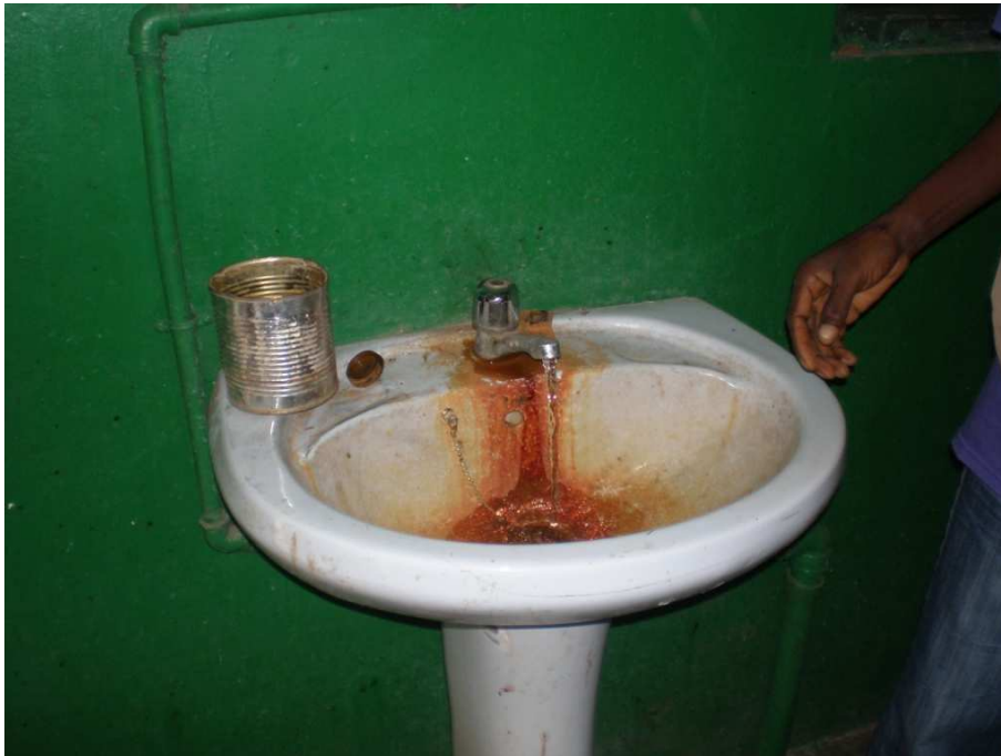
Foto 11. Manchas producidas como resultado de la corrosión de tuberías.
