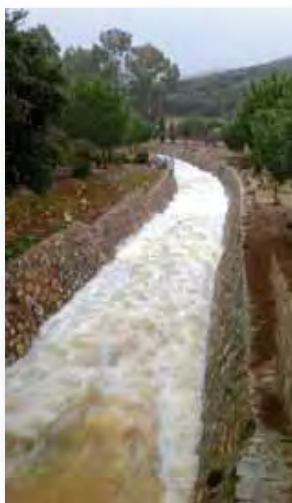
11 Canal del Becea aguas abajo de la Presa de Gasset. La canalización fluvial impulsa la transformación de los diferentes servicios fluviales en autopistas del agua, que circula velozmente por el territorio sin dejar ningún valor añadido.
