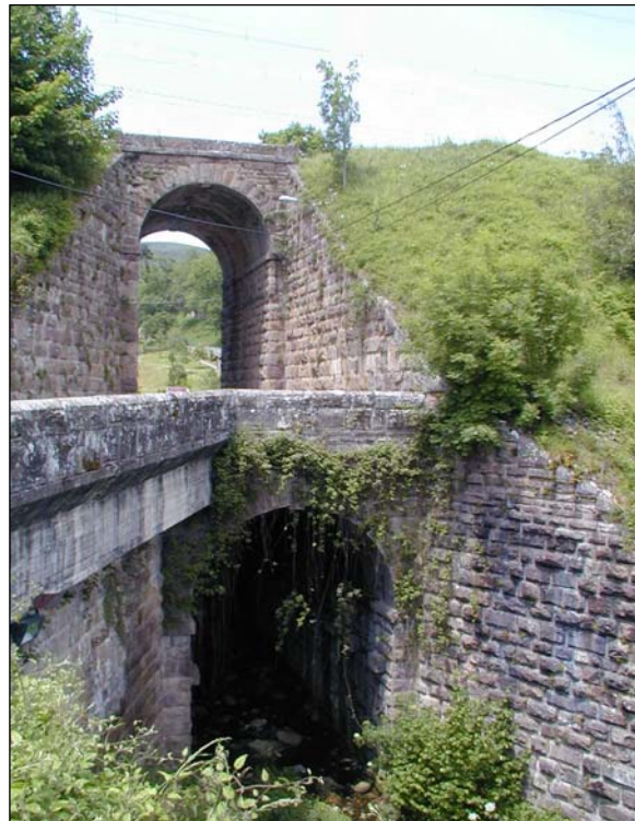
Fig. V.52.- Puente doble del ferrocarril sobre un arroyo y sobre la carretera de acceso a Pesquera.
