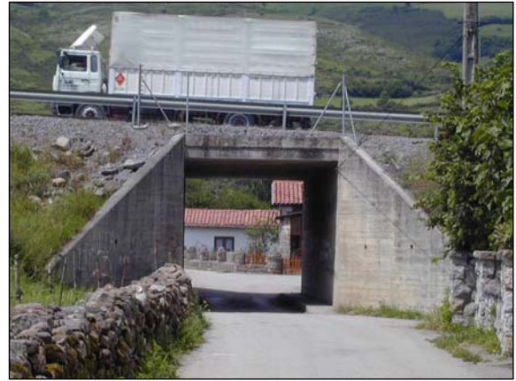
Fig. V.123.- El camino anterior se desvía hacia este paso, un centenar de metros al sur.
