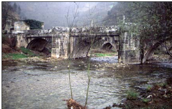
Fig. V.94.- Puente del Camino Real (1750) sobre el río Los Llares, cuya demolición fue considerada como alternativa en el diseño de los Accesos.
