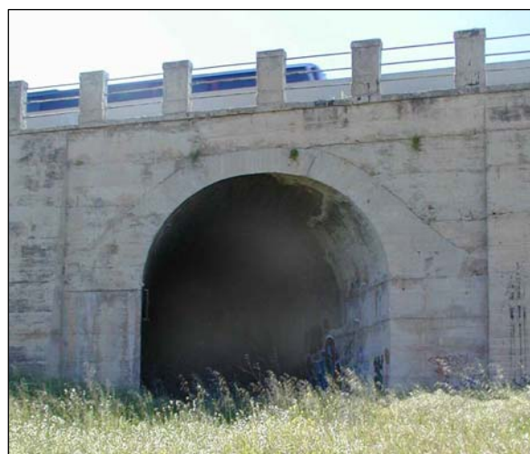
Fig. VI.58.- Paso sobre el antiguo ferrocarril de vía estrecha a Puertollano, cegado por el terraplén de la segunda calzada de la autovía, con lo que se perdió este paso para aumentar su permeabilidad. Obsérvese la tipología de la estructura idéntica a la del paso sobre la Regenta en la N-611 (Fig. V.40 del capítulo V), proveniente de las colecciones oficiales.
