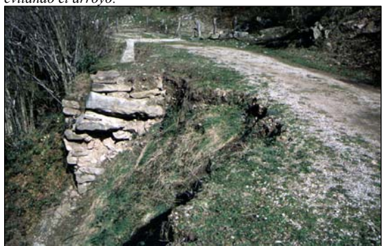
Fig. V.12.- Ruptura de un muro que permite observar la sección del muro de sostenimiento.
