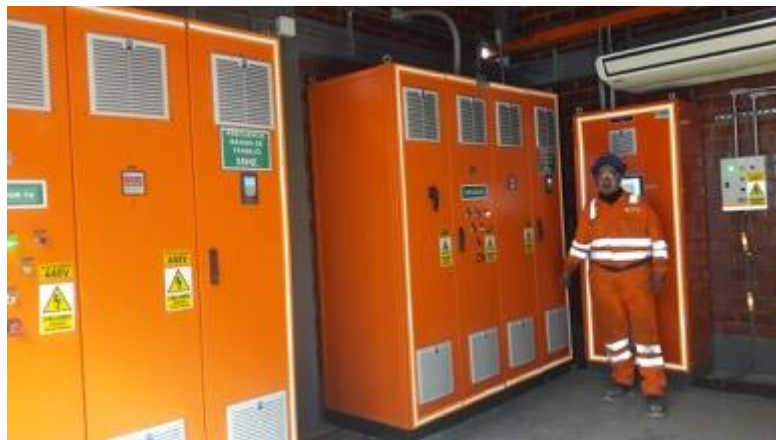
Fotografía N° 9. Evidencia del manejo del sistema SCADA como entorno de automatización para la distribución de energía eléctrica.
