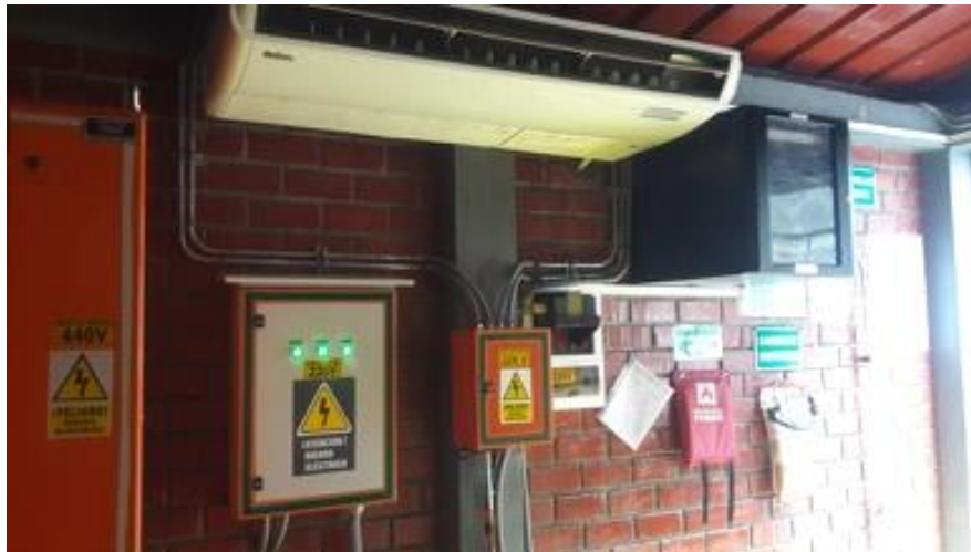
Fotografía N° 5. Tablero de accionar eléctrico.
