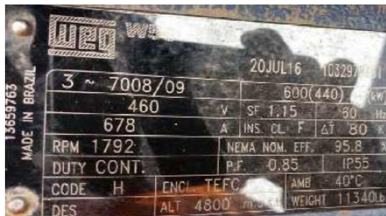
Placa de características del motor eléctrico.
