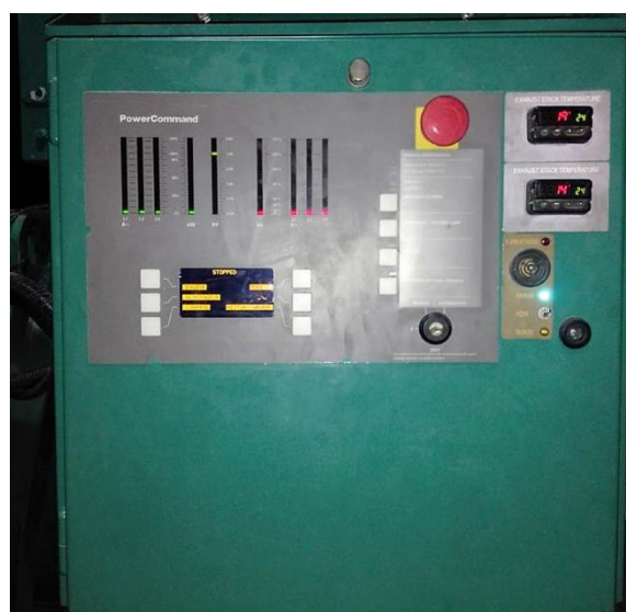
Panel de control del Generador G5.
