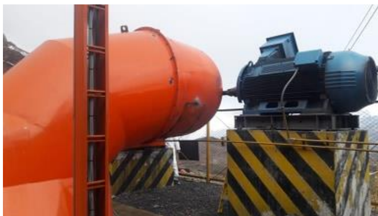
Fotografía N° 2. Motor que acciona el sistema de ventilación para un troncal.
