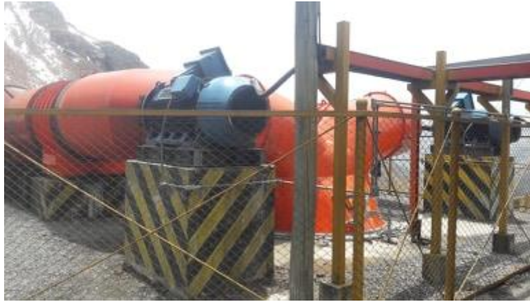
Fotografía N° 4. Vista de los motores en los troncales.
