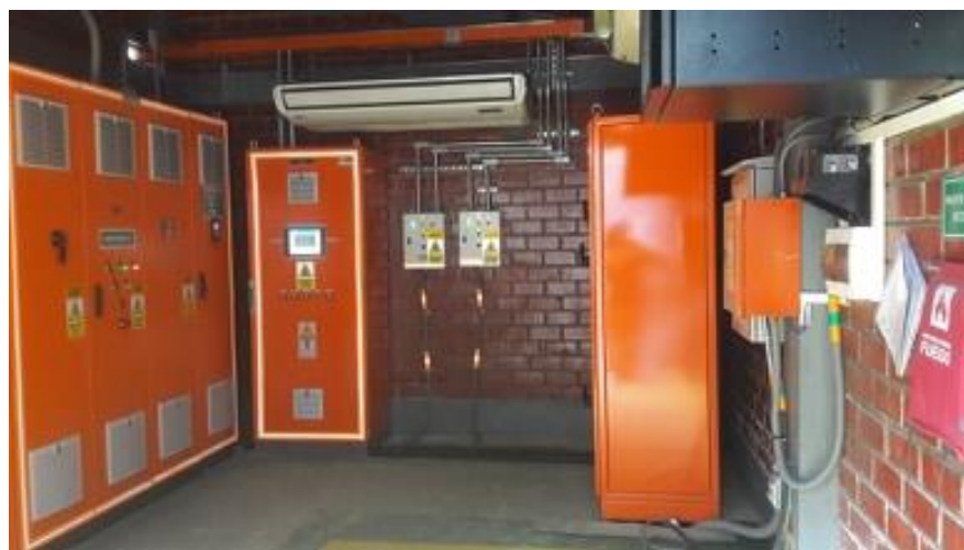
Fotografía N° 6. Área de control del sistema SCADA.
