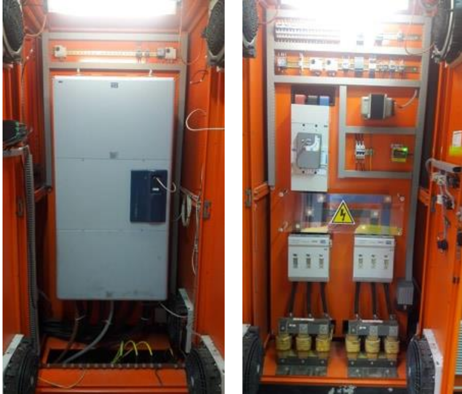
Fotografías N° 7 y 8. Panel de acción y distribución de energía.
