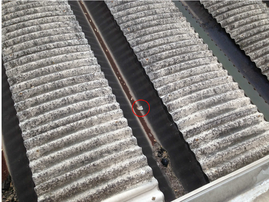
Figura 2.14: Lastre di cemento-amianto che mostrano segni di cedimento strutturale (nel cerchio un frammento di lastra).
