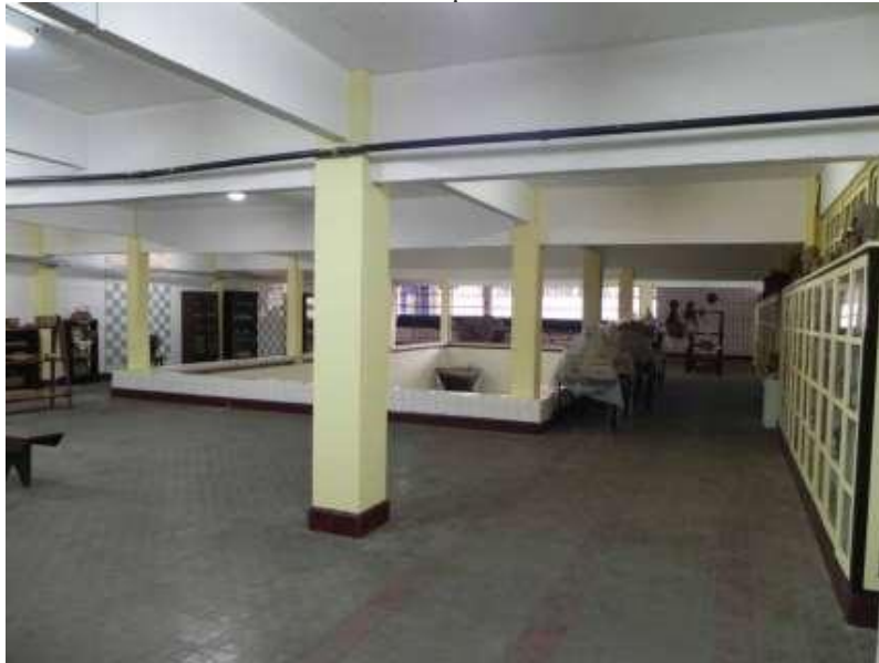
Figura 4 – Destaque para as vigas e pilares em concreto da parte ocupada pela exposição do Museu de Arte Popular do IFB
