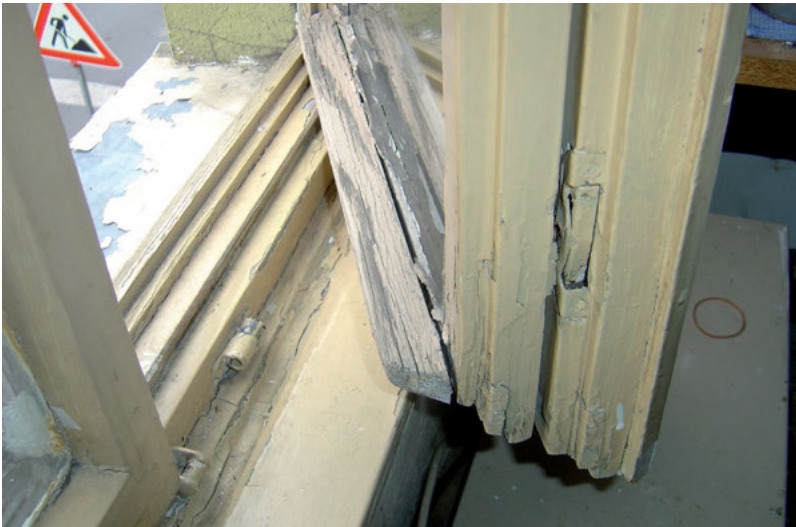
Der Berater nimmt auch undichte Fenster und Türen auf und setzt sich beispielsweise mit dem Vermieter in Verbindung.
