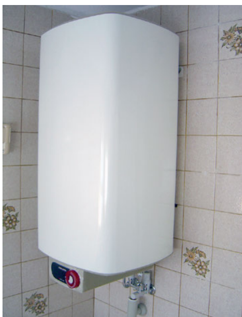
Energieerater treffen häufig auf völlig veraltete und ineffiziente Geräte zur Warmwasserbereitung. Der Stromverbrauch ist immens.
