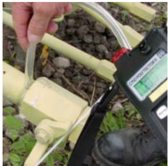
Foto 8: Screening von Armaturen mit GfG-Gerät.
