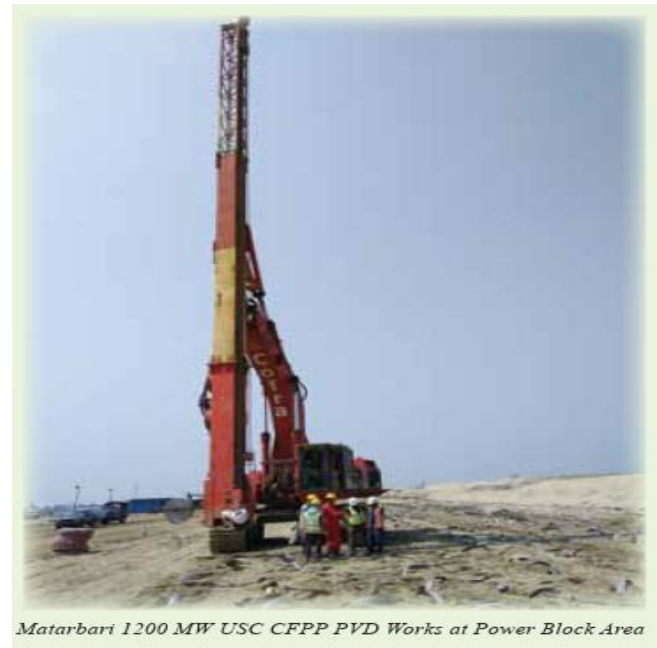
Fig. 03 : Matarbari 1200 MW Power Plant
