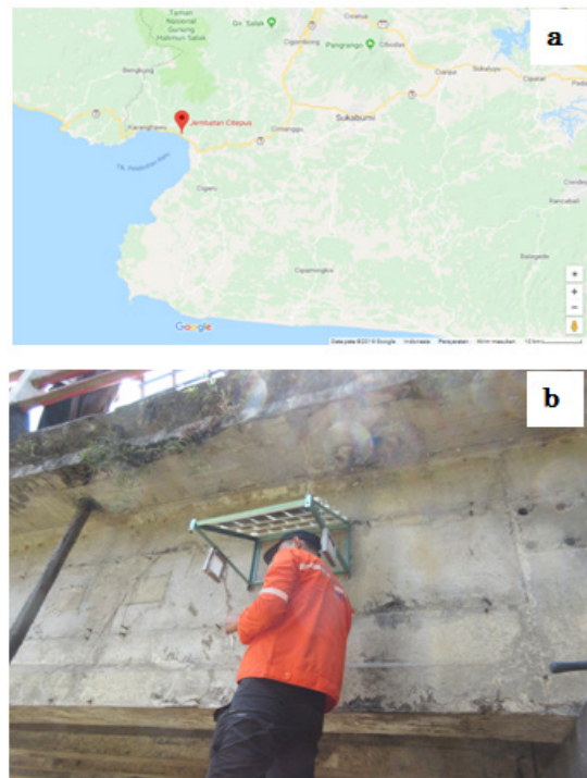
Gambar 1. a) Lokasi pemasangan rak uji di jembatan Cidahon, Pelabuhan ratu, Jawa Barat; b) Pemasangan rak uji di jembatan.
