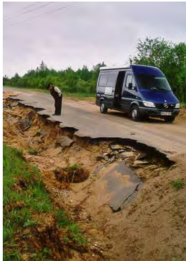
Abbildung 9.9: Unterspülte Straße zwischen Korma und Volincy
