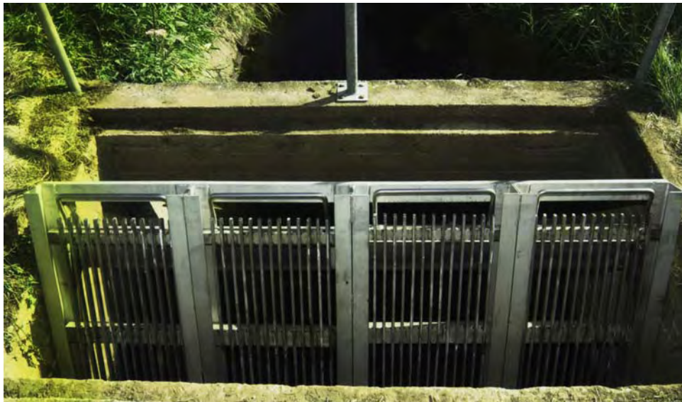
Abbildung 1-10: Rechen am Stichkanal (4 Rechenelemente) der Kühlwasserentnahme an der Rur
