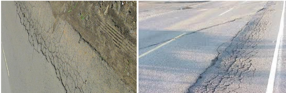
Gambar 1 Jenis Kerusakan Akibat Pelaksanaan Pelebaran yang Kurang Maksimal
