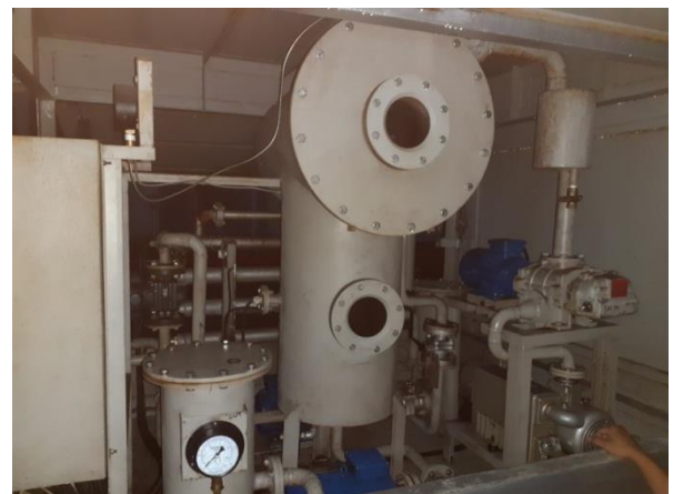
Gambar 2. Separator minyak transformator
