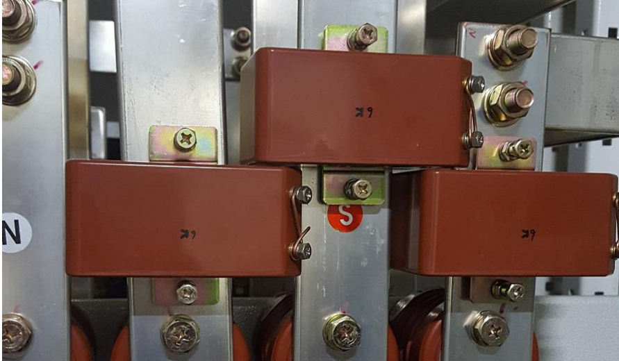
그림 1.2. 3상 버스바에 설치된 부싱형 대전류 변류기
