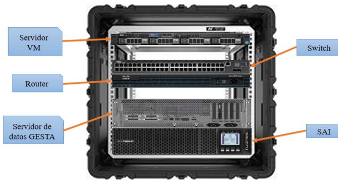
Figura 3.2-2: Disposición equipos sobre rack Pelican Harding Super V Series
