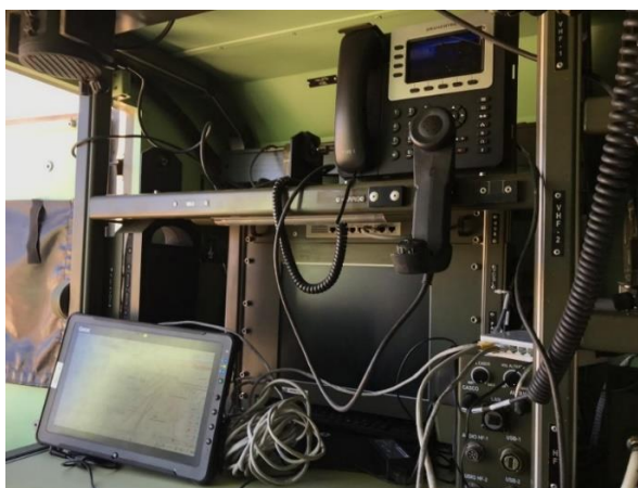
Ilustración 18. Tablet con capacidad BMS en estación Mercurio. Fuente: elaboración propia
