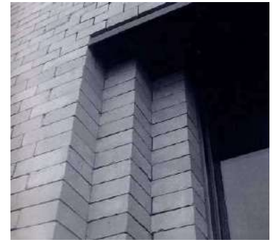
Detalle de jamba de la ventana donde podemos apreciar la junta a hueso.
