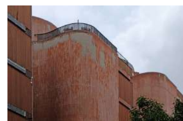
Ejemplo de la caída de material cerámico de la fachada.
