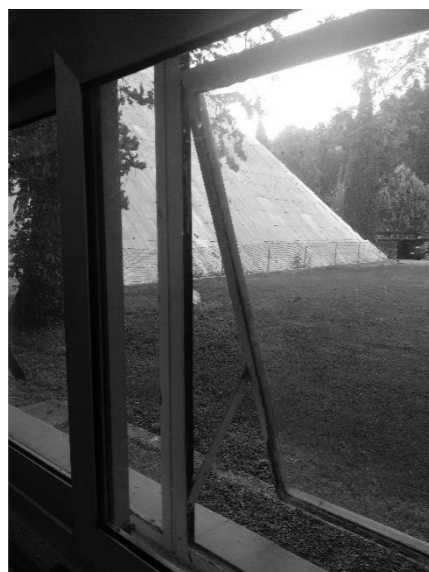
Intervención en aulas con pérdida de parte inferior de la carpintería
