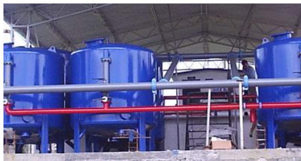
Foto 2. Planta de Tratamiento de Acueducto Tribunas – Córcega
