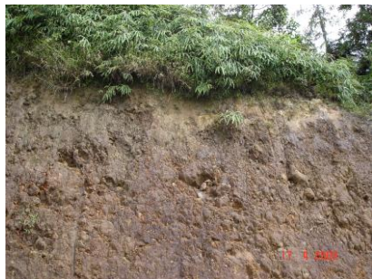
Foto 5. Huella de antiguo deslizamiento
