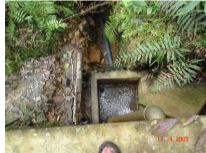
Foto 10. Tubería de descarga Vereda El Manzano
