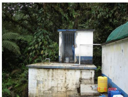
Foto 13. Tanque de cloración Vereda El Manzano
