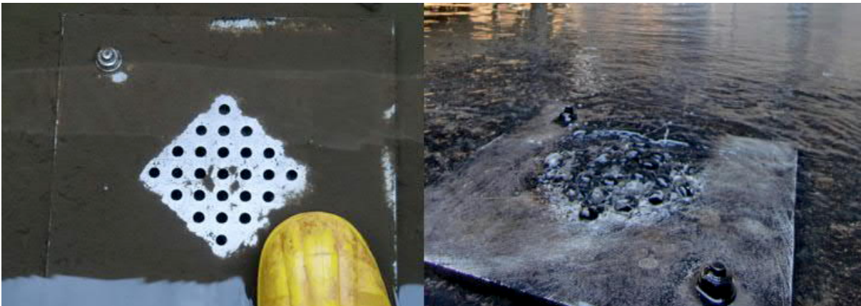
Bild 3: Entlastungsöffnung ohne (links) und mit (rechts) Wasseraustritt
