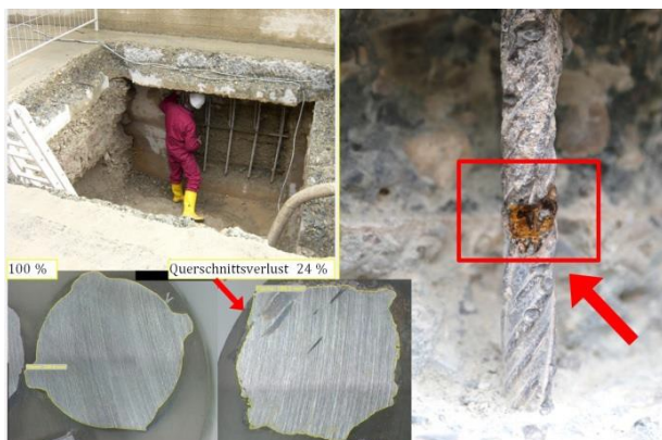
Abbildung 11 Bewehrungsfreilegung im Bereich des Maschinenhauses einer Schleuse mit Fotos der Bewehrung sowie Querschliff-Darstellungen von ungeschädigten und korrodierten Querschnitten
