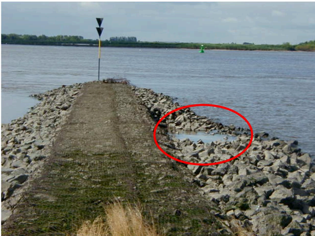
Bild 8: Fehlstelle an der Abdeckung eines Stacks am Nordufer der Unterelbe (aus: Staal 2011)
