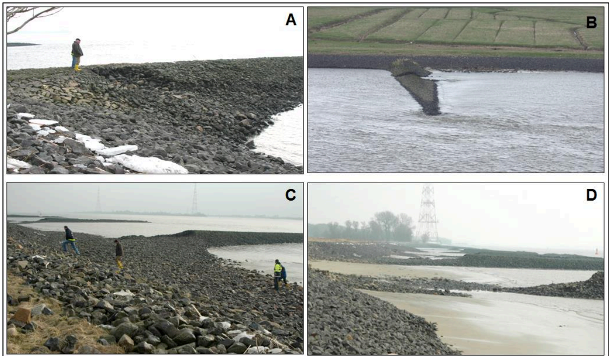
Bild 5: Entwicklungsstufen der Schäden an den Buhnen Juelssand (A: Erste Schäden in Lee, B: Kronennaher Durchbruch, C: Vollständiger Durchbruch, D: Aufweitung des Durchbruchs; nach BAW 2012a)
