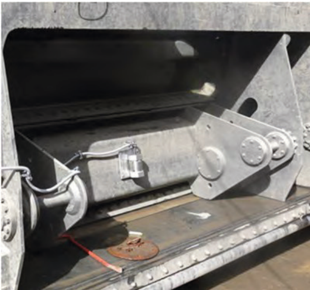
c) Beschleunigungssensor am Füllschützes eines Stemmtors und
