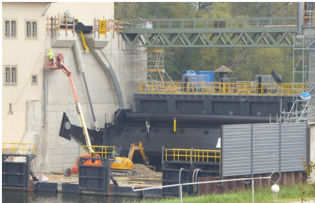
Abbildung 5: Bauzustand des Drucksegmentes (Quelle: IRS AG)
