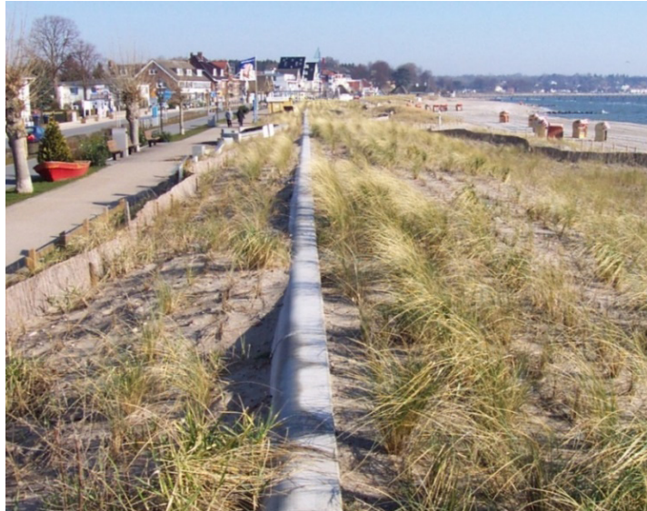
Abbildung 7: Hochwasserschutzsystem „versteckt“ im aufgeschütteten Strandwall (© Hofstede).
