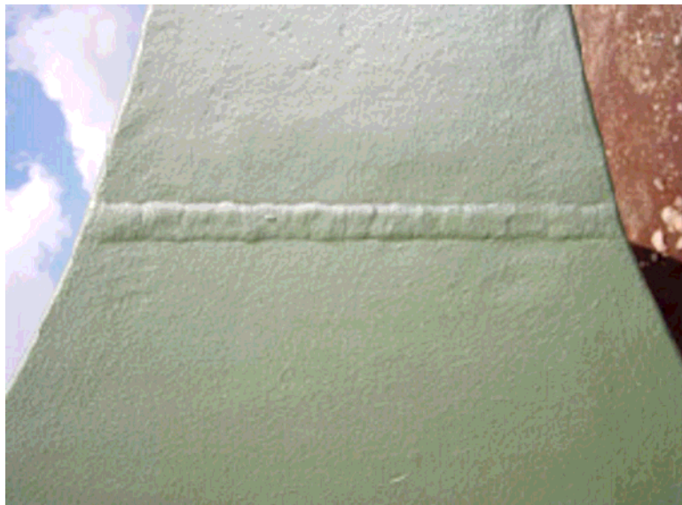
Bild 7: Überhöhte Schweißnaht zwischen Spaten und Anschlussblech
