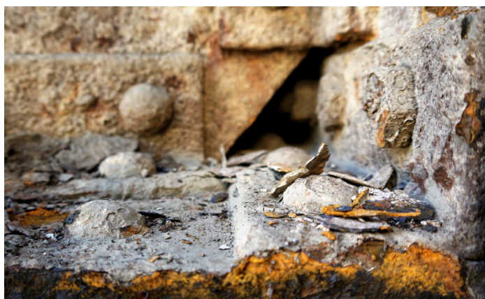
Bild 1: Detailaufnahme eines Korrosionsschutzschadens eines Schleusenobertores am Neckar.
