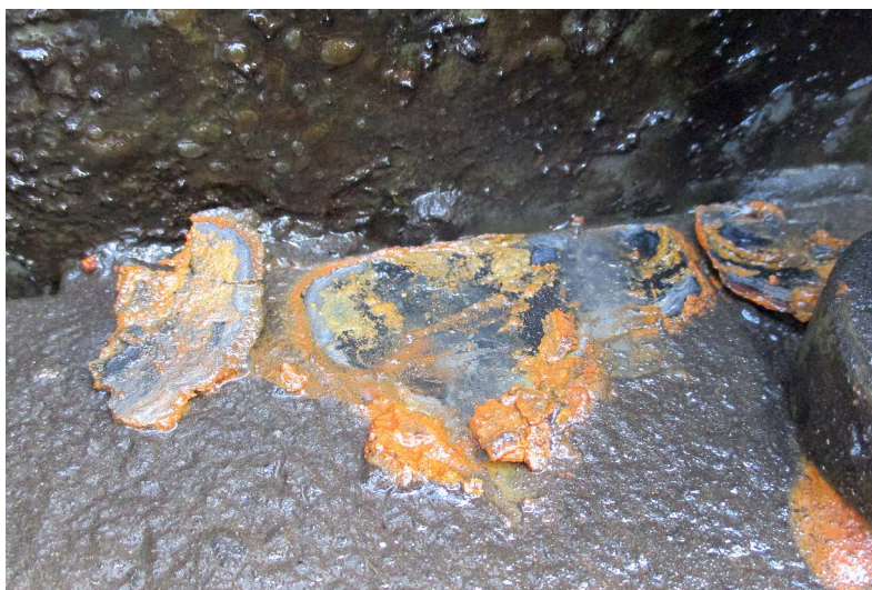
Bild 1: Abgelöste, auffällige Rostpusteln an einem Edelstahlblech in einer Schleuse, an welchen deutlich Sulfide nachgewiesen wurden.
