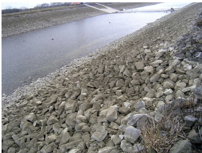
Bild 1: Beispiel für einen Deckwerksschaden infolge des Schraubenstrahls eines manövrierenden Schiffes am DEK, Los2b (2006).
