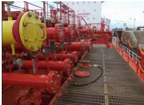
Gambar 2.8 Manifold Sumber: Dokumentasi Pribadi
