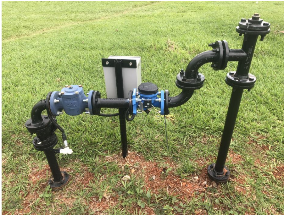
Figura 4.5 Cavalete com hidrômetro ultrassônico instalado na saída sul do ICC.
