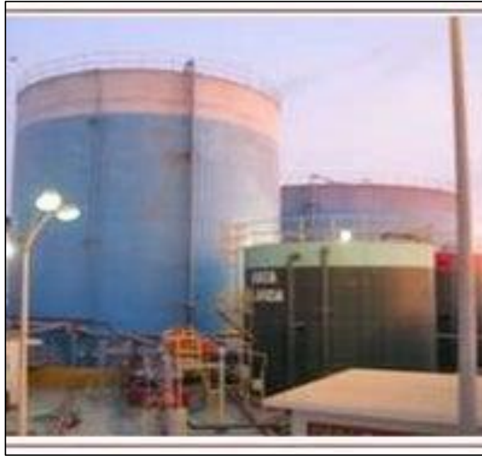
Figura 25. Tanques de soda caustica.
