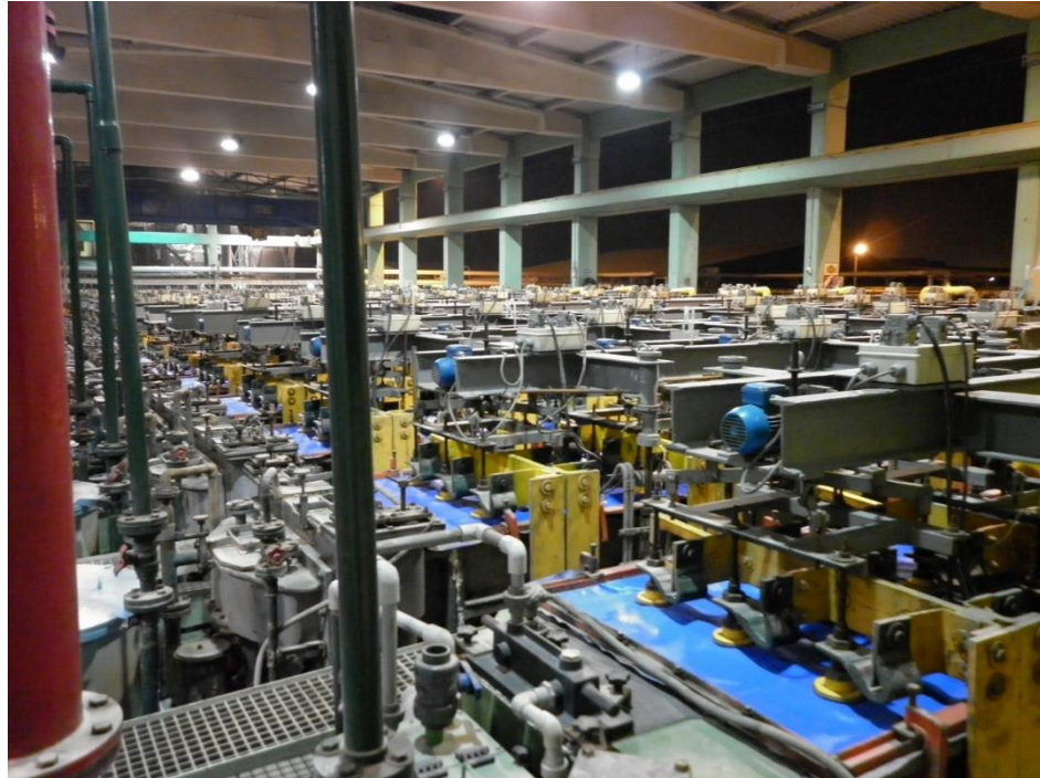
Figura 40. Sala de celdas lugar de aplicación de TPM
