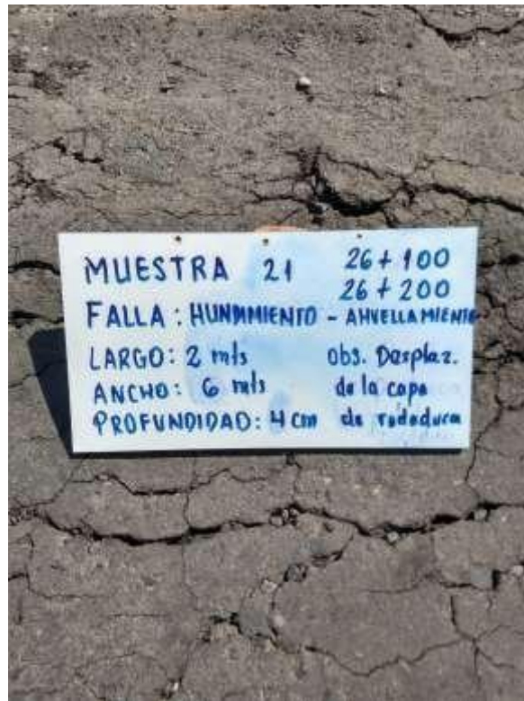
Fotografía N° 11: Documentación de fallas
