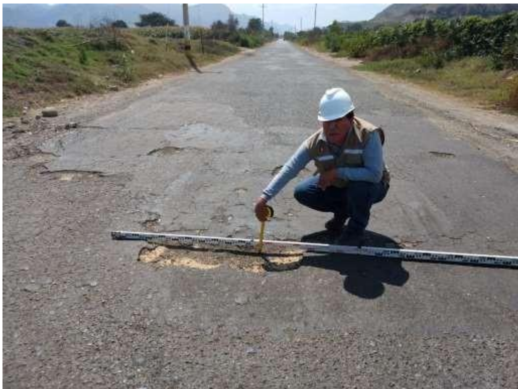
Fotografía N° 12: Documentación de fallas
