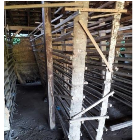
Gambar 1 Rak Pengering Dari Kayu Yang Sudah Rusak
