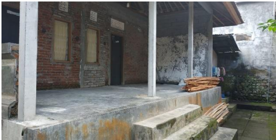
Gambar 3 Tampilan Bangunan Sebelum Perbaikan
