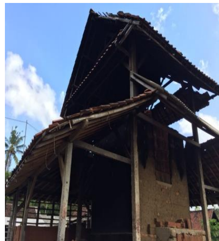
Gambar 5 Tungku Pembakaran Yang Atap Penutup Menggunakan Genteng (Sebelum Perbaikan)
