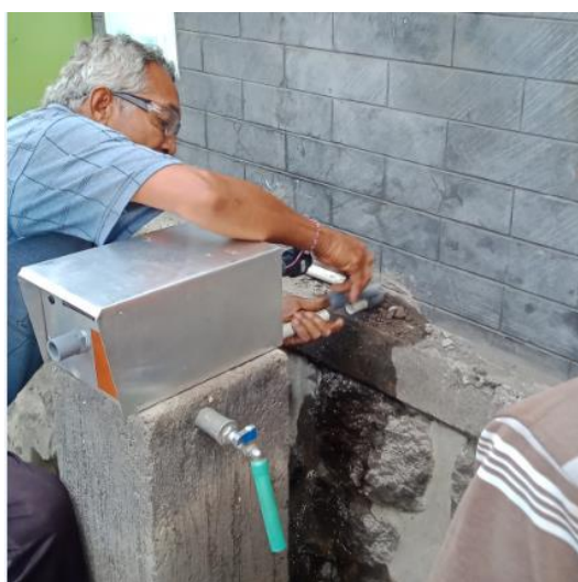
Gambar 8. Pelatihan pemasangan pemipaan pada sistem layanan air minum berbasis kartu RFID
