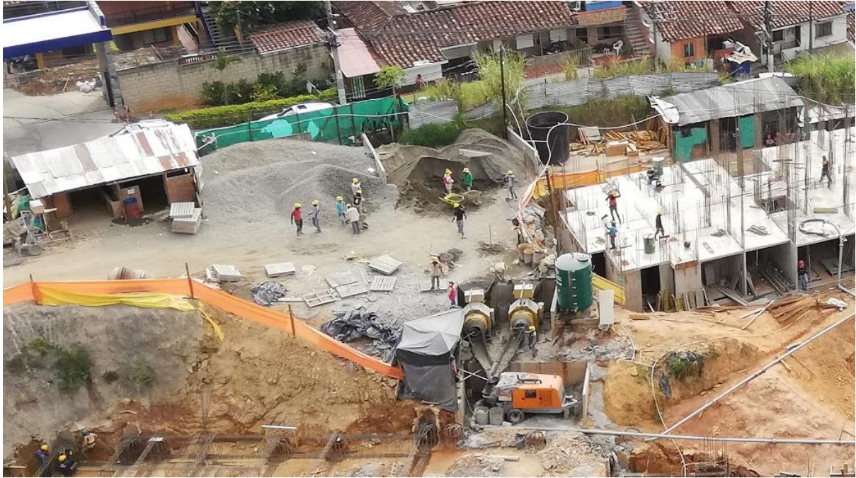
Foto 1. Planta de fabricación del concreto
