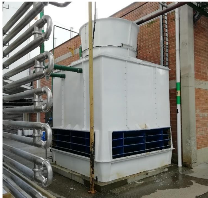
Figura. 22 Torre de enfriamiento evaporador
