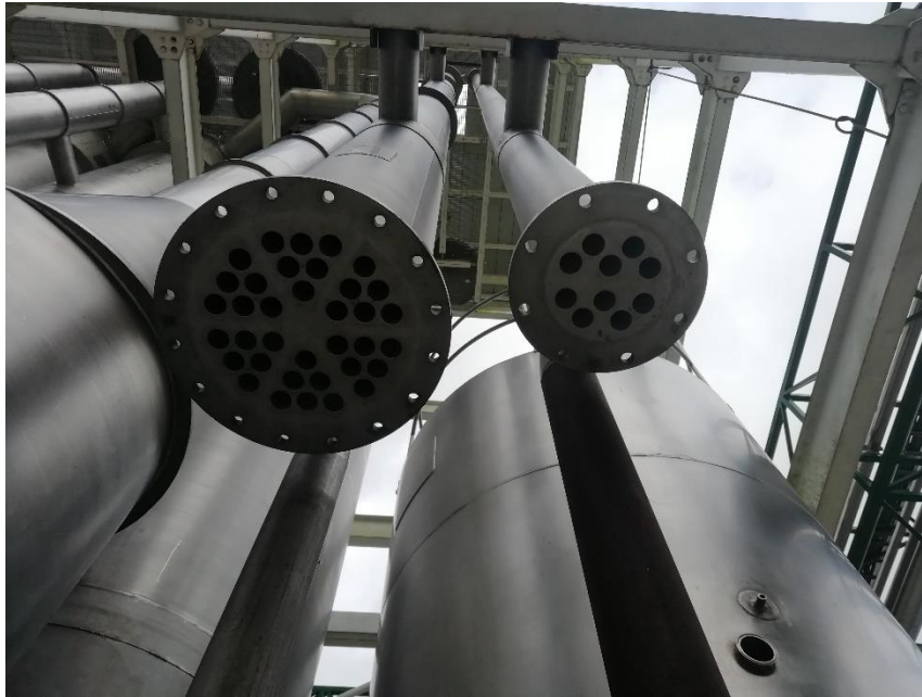
Figura. 34 Pasteurizador de coraza y tubos
