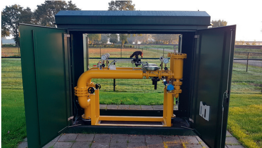
Afbeelding 5.4 Districtstation opgesteld in een roestvrij stalen kast met de afmetingen 2,5 x 1 x 2m.
