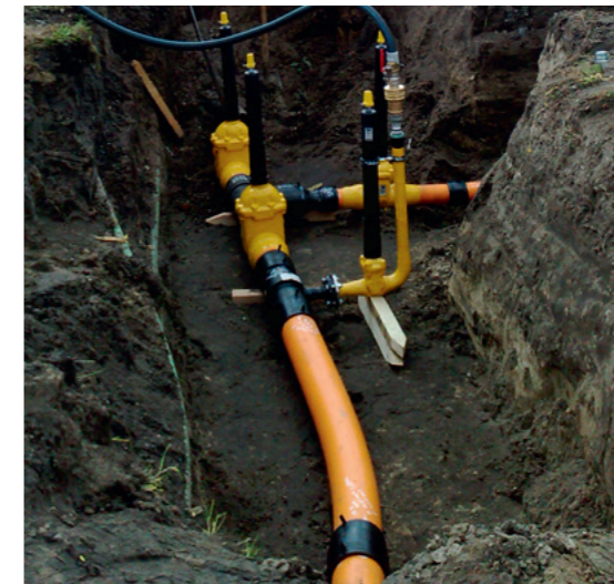
Afbeelding 5.3.a Distributienet hoge druk: leidingnet samengesteld uit PE-buizen, inclusief hulpstukken als verbindingsmoffen, bochten en T-stukken.
