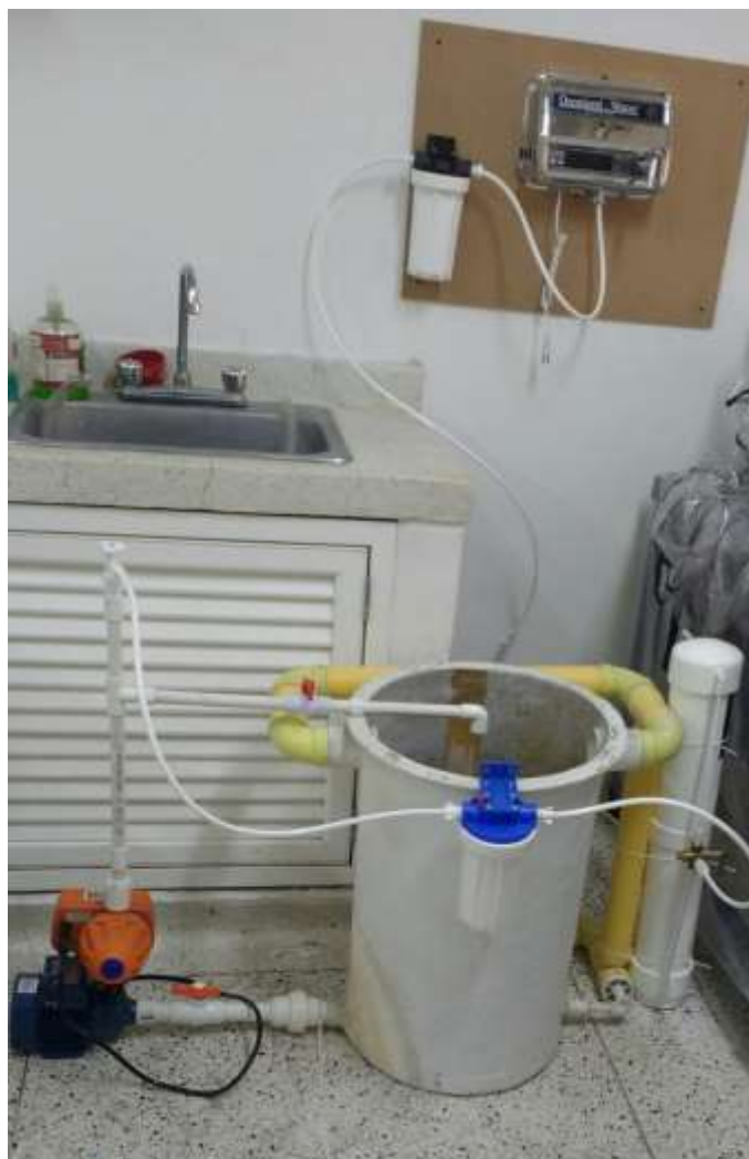
Figura 38 Fase final del sistema de tratamiento de agua residual. Fuente: elaboración propia
