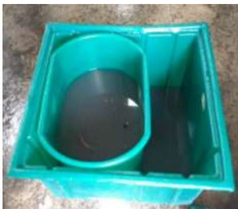
Figura 35 Trampa de grasa en funcionamiento. Fuente: elaboración propia
