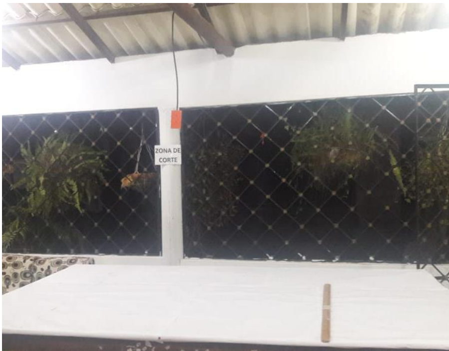
Figura 33. Colocación de instalación eléctrica para la utilización de la cortadora. Fuente: Elaboración propia.
