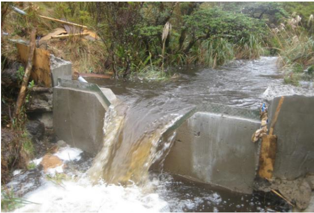
Figure 2.7 Exemple de déversoir avec une ouverture en V (tiré de Buytaert et al., 2014)
