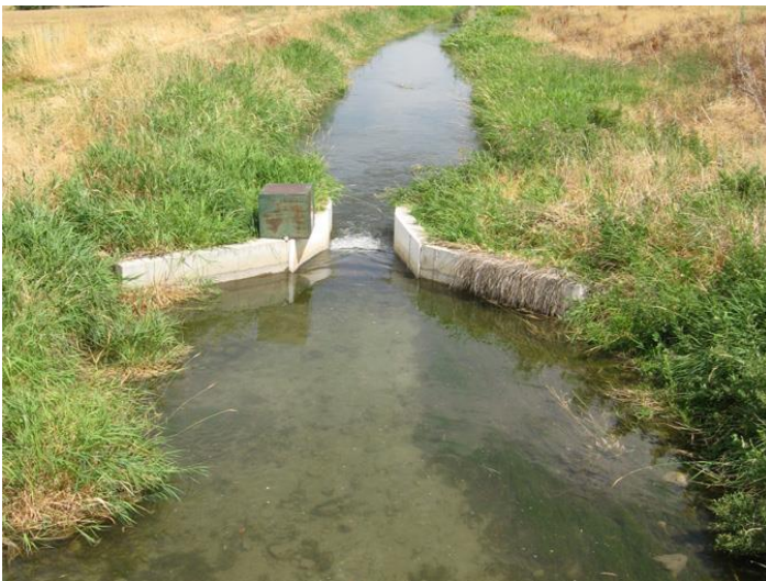
Figure 2.6 Exemple de canal jaugeur installé dans un fossé (tiré de Tullis & barfuss, 2009)
