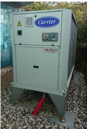
Figur 4. Varmepumpen placeret uden for svømmehallen.
