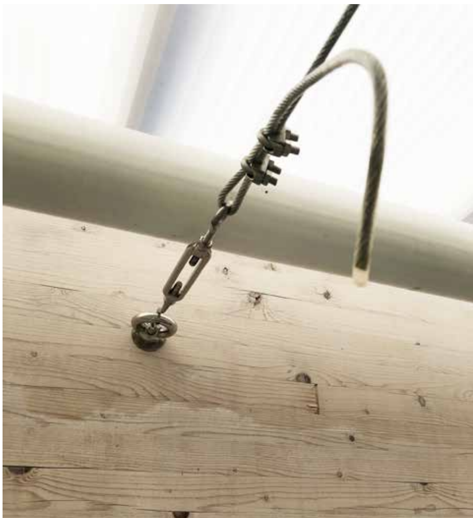
Ophængskomponenter fra FabricAir efter 10 år i et korrosivt miljø.
