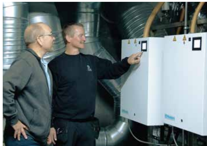
Efter installationen kan Michael Herse konstatere, at indeklimaet er forbedret og medarbejderne udtrykker tilfredshed med løsningen.
