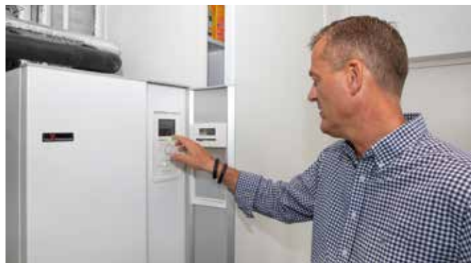
Passiv køling sænker temperaturen i huset med tre-fire grader og giver et dejligt indeklima.
