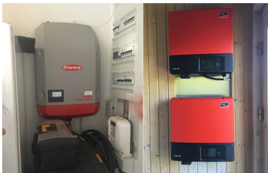
Figur 6: Hvad er en inverter, og hvordan fungerer den? Der skal opbygges en teknisk kompetence for at kunne udnytte anlæggets potentiale. Hvis man ikke forstår det, er det svært at udnytte.
