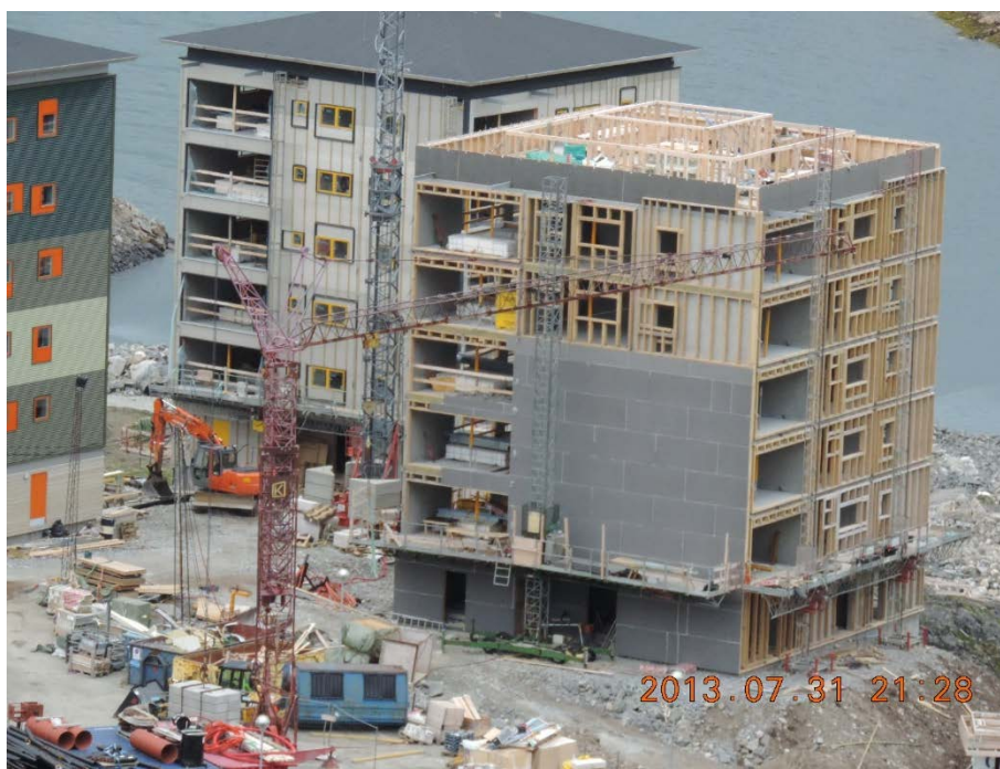
Figur 9. Råhuset er udført som pladsstøbt armeret betøn, hvorpå der er opsat et træskelet med isolering og uden på facadeplader eller træbeklædning, som bliver produceret på stedet.
