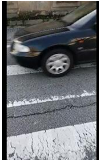
Figura 31 - Travessia insegura realizada na EN 1 (Fonte: Vídeo nos Anexos)
