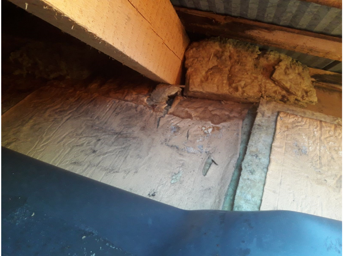
Kuva 4. Kosteusrasituksesta vaurioitunut lasikuituvilla yläpohjassa
