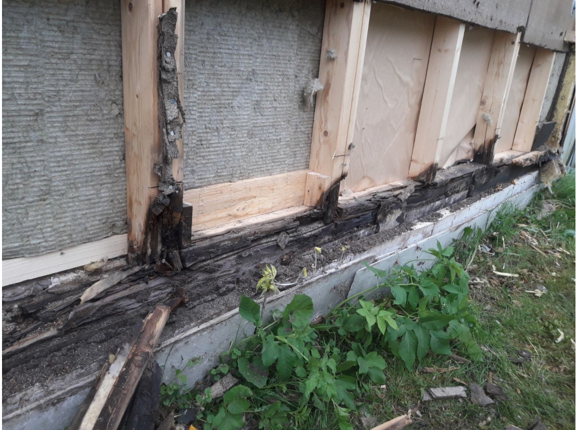
Kuva 3. Paneloinnin alta paljastunut pahoin vaurioitunut alajuoksu
