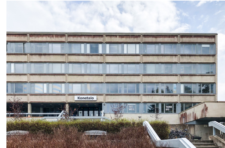
Kuva 17. Tampereen yliopiston Konetalon betonijulkisivun pintaan on ilmestynyt punajäkälä-vyöhyke. Muutoksella ei ole julkisivun suorituskykyä heikentävää vaikutusta. Sen pois peseminen on kyse esteettisestä valinnasta.
