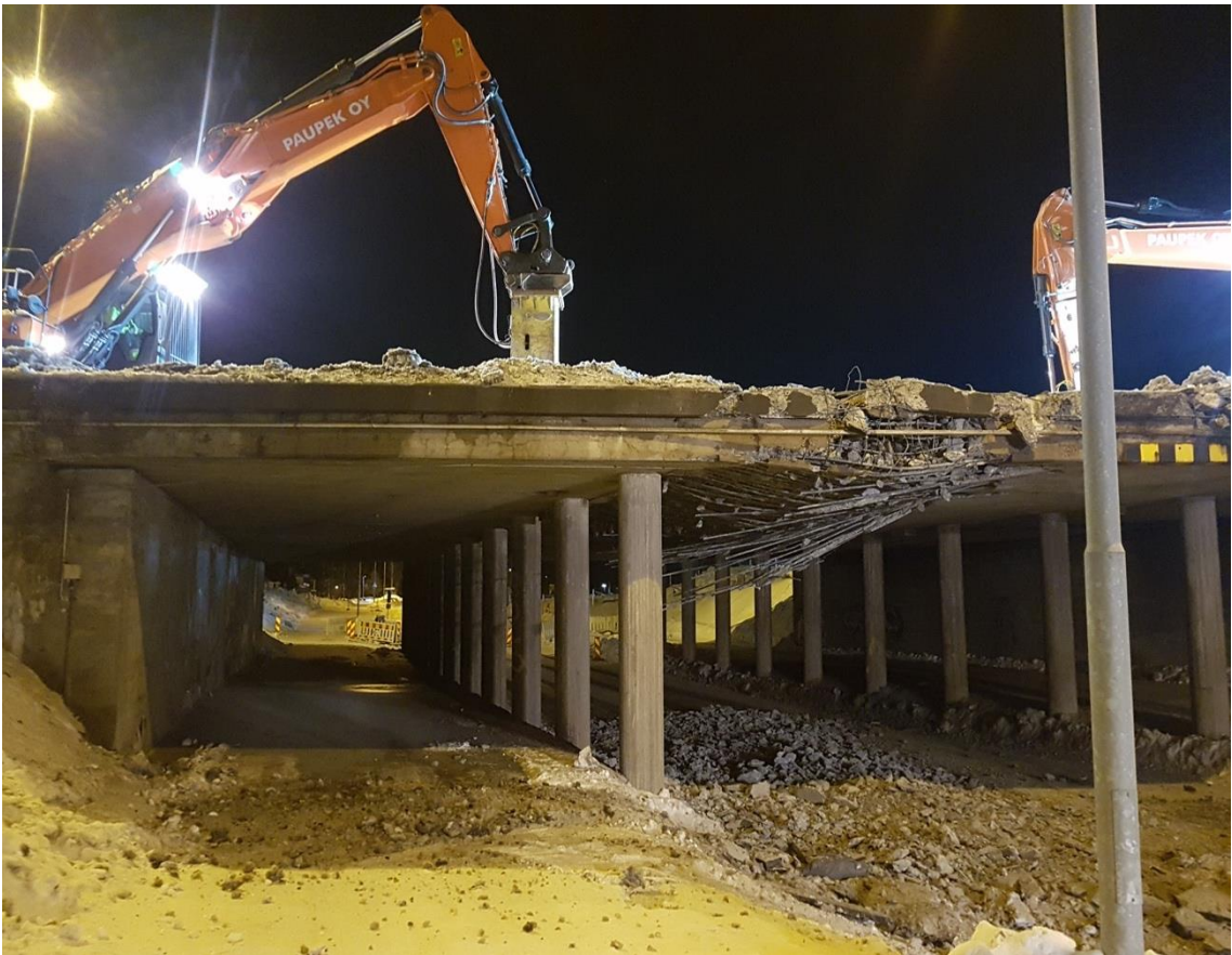
Kuva 3. Kaivinkoneet purkamassa siltaa, joka todettiin liian huonokuntoiseksi ajokaistan lisäämistä varten. (Kuva Antti Autere)
