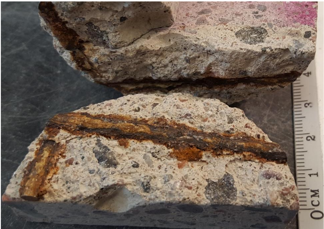
Kuva 13. Voimakkaasti ruostuneita teräksiä. Korroosiotuotteet kertyvät terästen pinnoille ja aiheuttavat painetta betoniin. Tämän seurauksena betoniin voi muodostua säröilyä ja lohkeilua. (Kuva Antti Autere)
