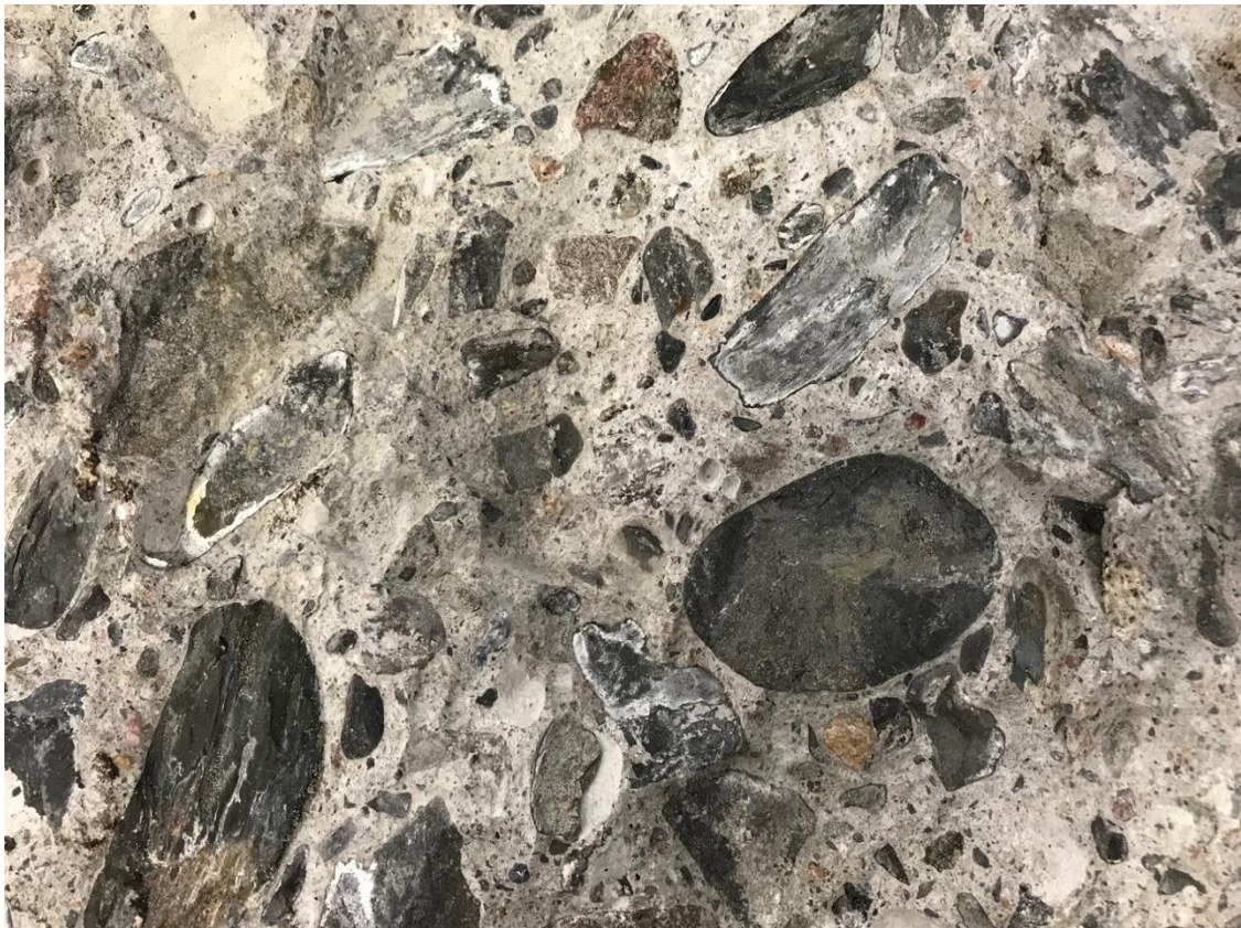
Kuva 10. Alkalikiviainesreaktiota sillasta irrotetussa kappaleessa. Kuvan leveys luonnossa on noin 5 cm. (Kuva Antti Autere)
