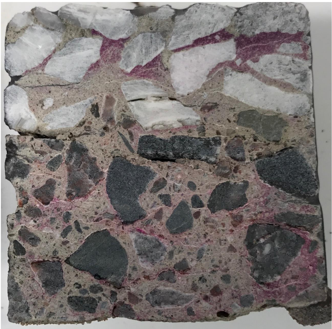
Kuva 7. Pakkasrapautumisen aiheuttamaa pinnansuuntaista säröilyä asuinkerrostalon julkisivusta poratussa näytteessä. Näytteen halkaisija on 55 mm. (Kuva Antti Autere)
