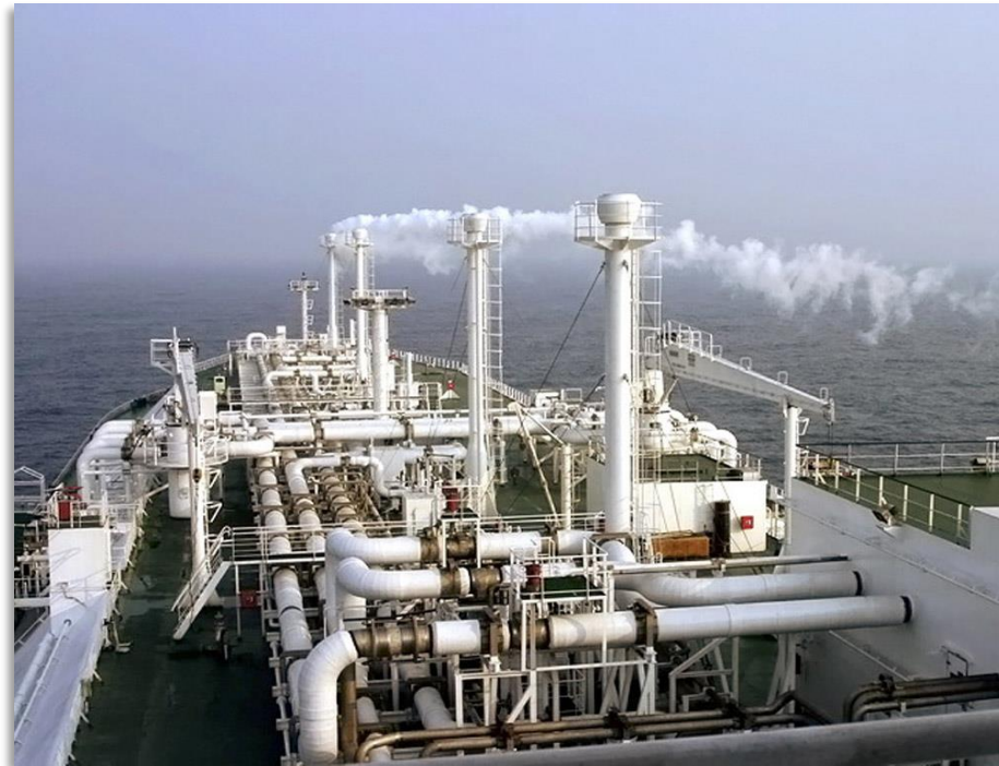
Imagen 29: Buque LNG venteando gas a la atmósfera para aliviar la sobrepresión en el sistema de carga. Fuente: Kairong (49) .
