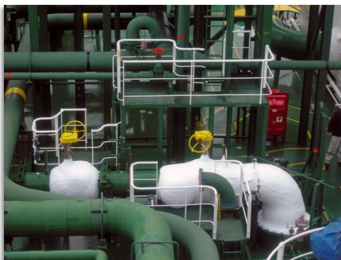
Imagen 37: Enfriamiento de las líneas en cubierta. Se aprecia la formación de escarcha. Fuente: LNG Sea Term.
