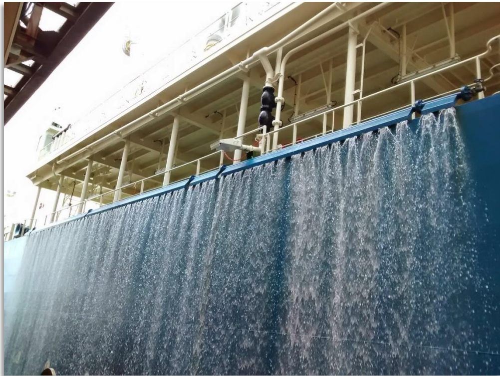
Imagen 36: Cortina de agua en funcionamiento. Fuente: LNG Sea Term.
