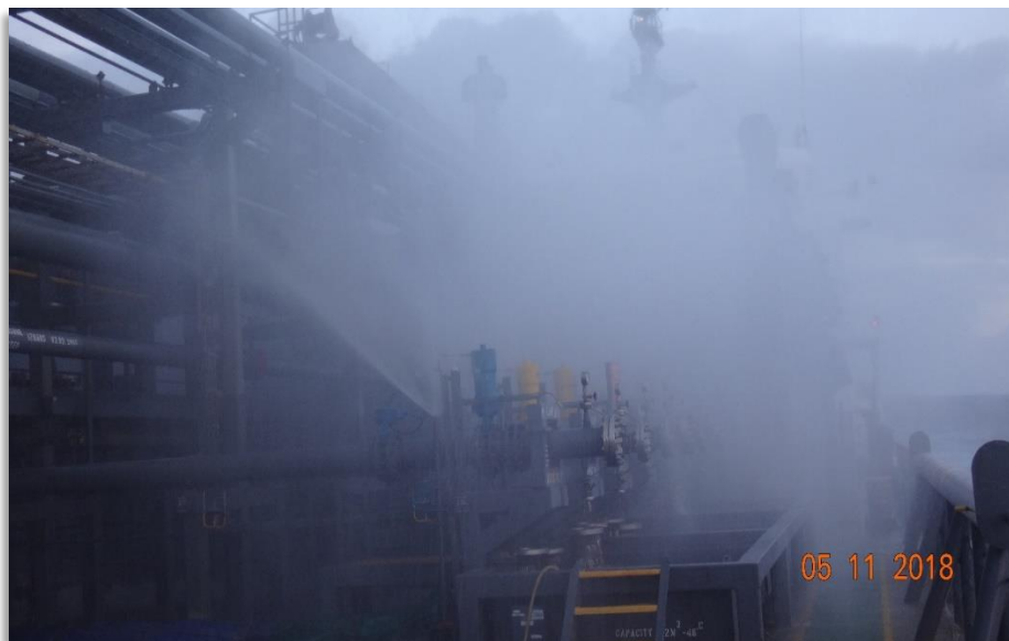
Imagen 32: Water Spray activada en cubierta. Fuente: Elaboración Propia.
