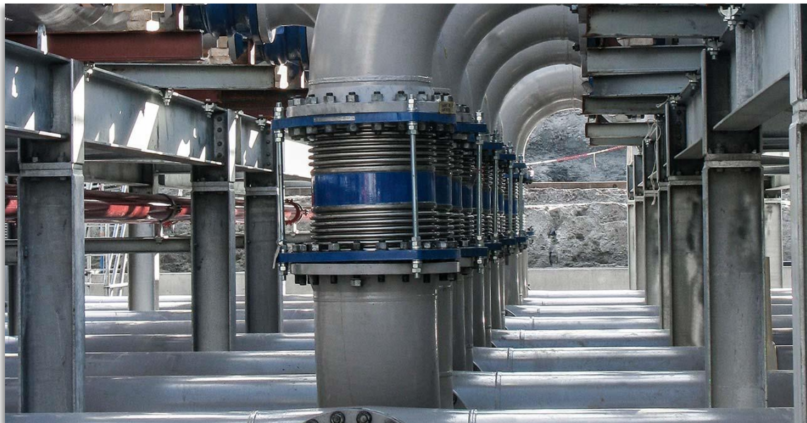
Imagen 27: Anillo de expansión/contracción térmica en líneas de líquido de una terminal, similares a los utilizados a bordo. Fuente: Belman Engineering.
