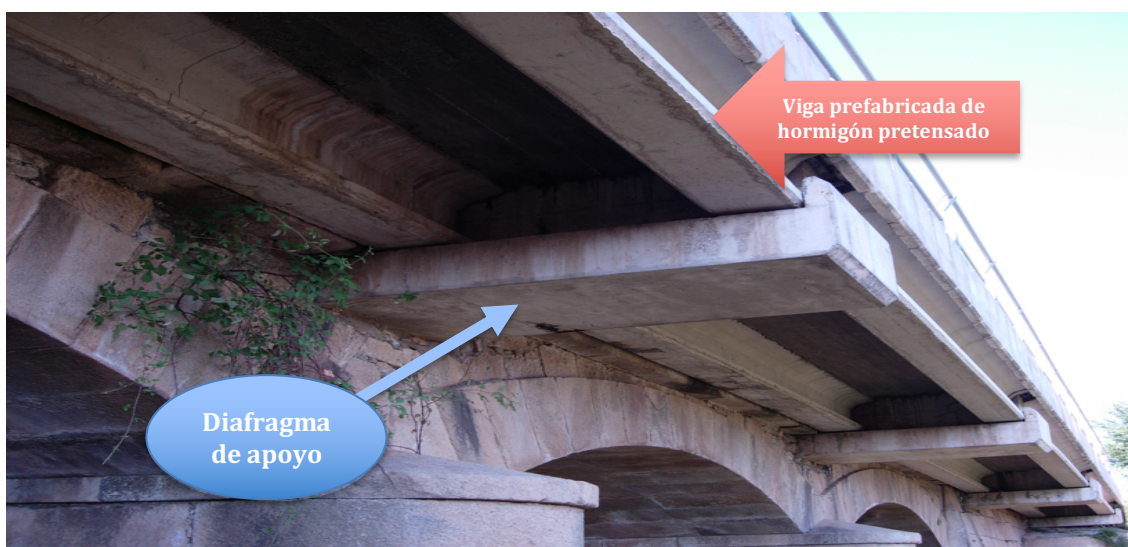
Figura 19: Vista en detalle de el apoyo en los diafragmas de pila de las vigas prefabricadas.
