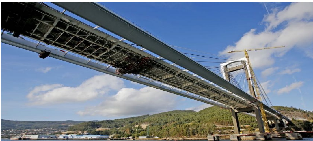
Figura 82: Vista inferior del Puente en fase de finalización de las obras de ampliación.
