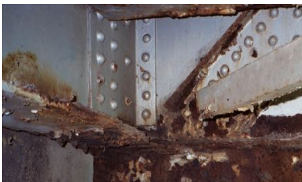
Figura 9: Pérdida de recubrimiento en vigas metálicas producido por el fenómeno de la corrosión.
